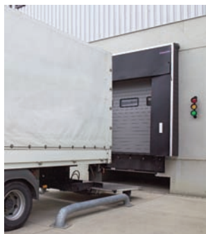
Système Dock Control.
