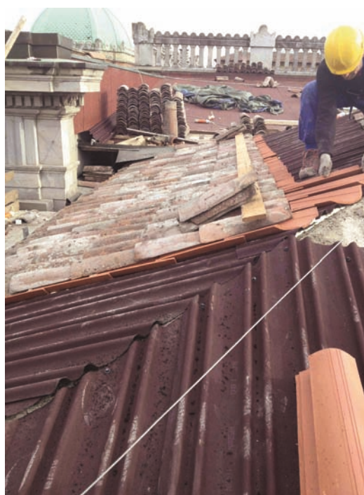
Une solution idéale pour les bâtiments historiques.
