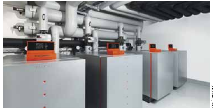
Cascade de pompes à chaleur géothermiques Vitocal 300-G
