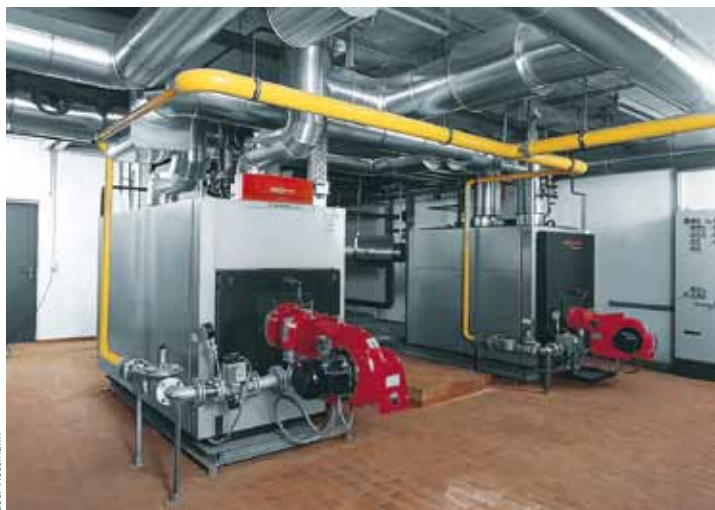
Chaudières gaz à condensation Vitocrossal 300 en cascade.
