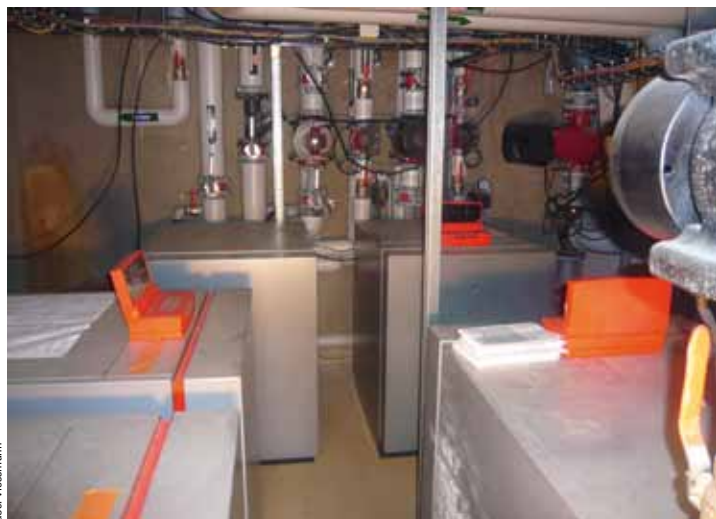
5 pompes à chaleur en cascade et 2 chaudières à condensation et ballons tampons
