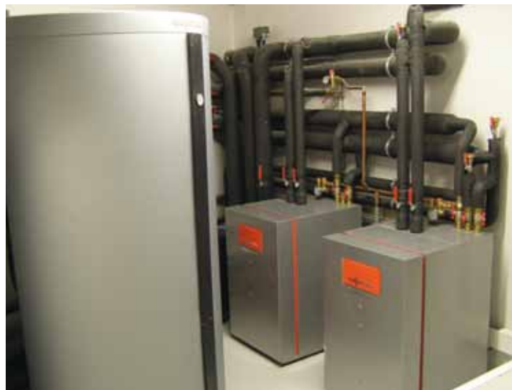
Pompes à chaleur Vitocal 300-G en cascade avec ballon tampon de 750 l (BE Gamba à Toulouse)
