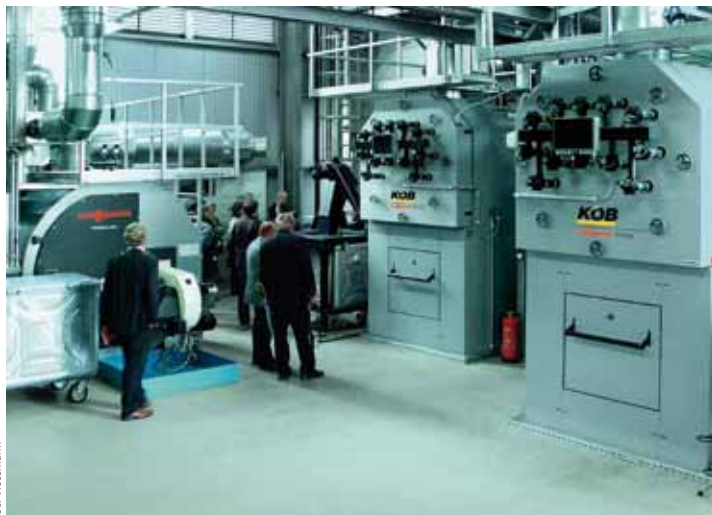
Chaudières bois KOB associées à une chaudière fioul/gaz de grosse puissance Vitomax
