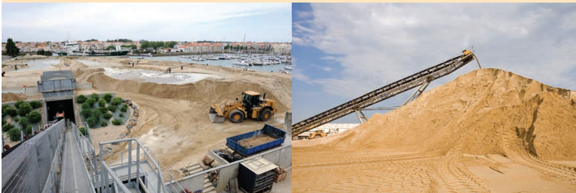
Les sites des Sables-d'Olonne (85) et de La Rochelle (17) comptent parmi les terminaux GSM de transformation et de distribution de granulats marins sur la façade Atlantique.
