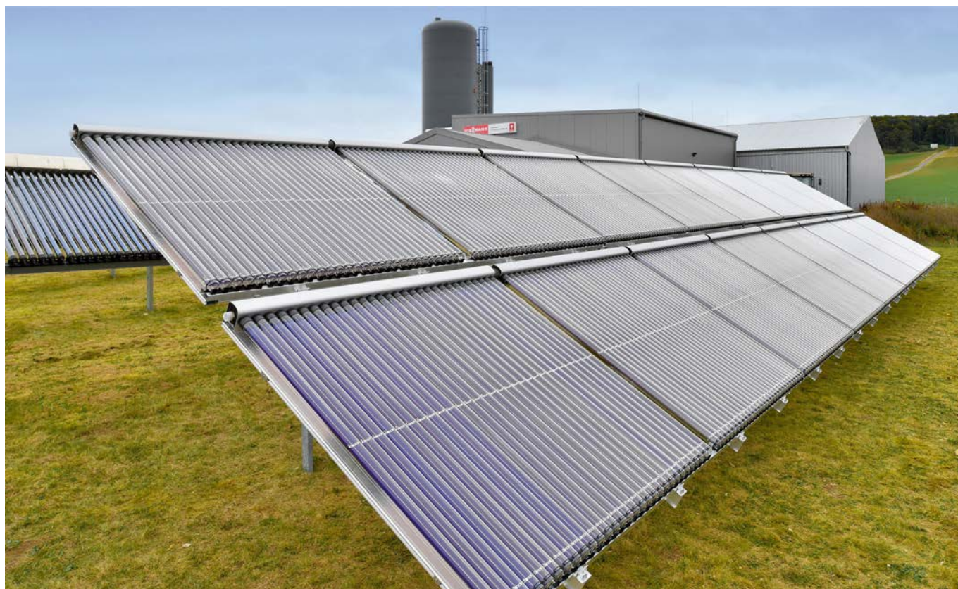
Capteur solaire Vitosol 200-T SPX, la nouvelle référence signée Viessmann Faulquemont (57).
