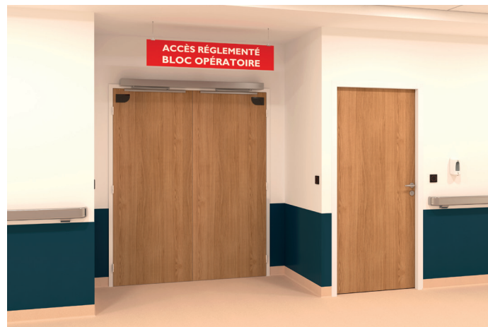
Ci-dessus : bloc-porte D.A.S avec opérateur d'ouverture MALERBA équipé d'un verrou électromécanique DORMAKABA TV500 et de détecteurs DORMAKABA Flatscan. Ci-dessous : extrait de la nouvelle documentation MALERBA.
