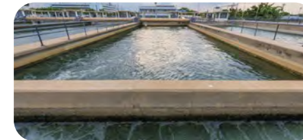
USINE DE TRAITEMENT EAU POTABLE
