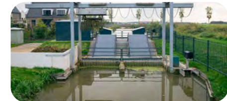
STATIONS DE POMPAGE
